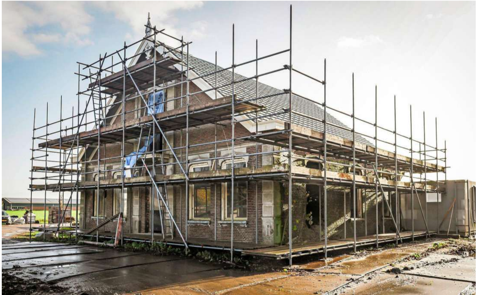
Het voorhuis staat in de steigers, het achterste deel wordt opnieuw opgebouwd.
